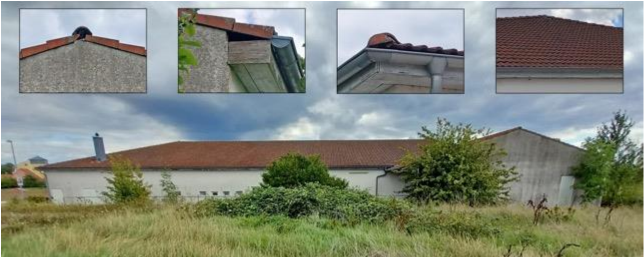
Abbildung 4: Ansicht des Gebäudes aus West (unten) und verschiedene defekte im Dachbereich; Foto: R. Fischer
